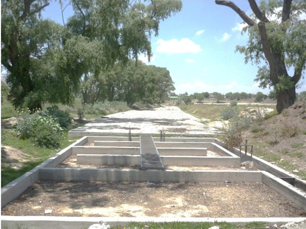
Figura 29. Panorámica general del tren de tratamiento
