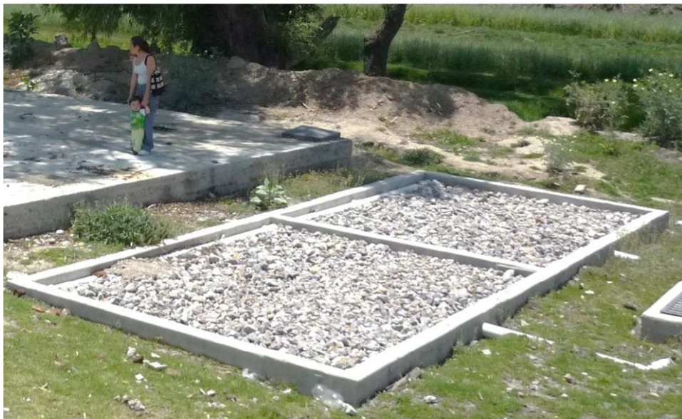
Figura 24. Celdas de mantenimiento
