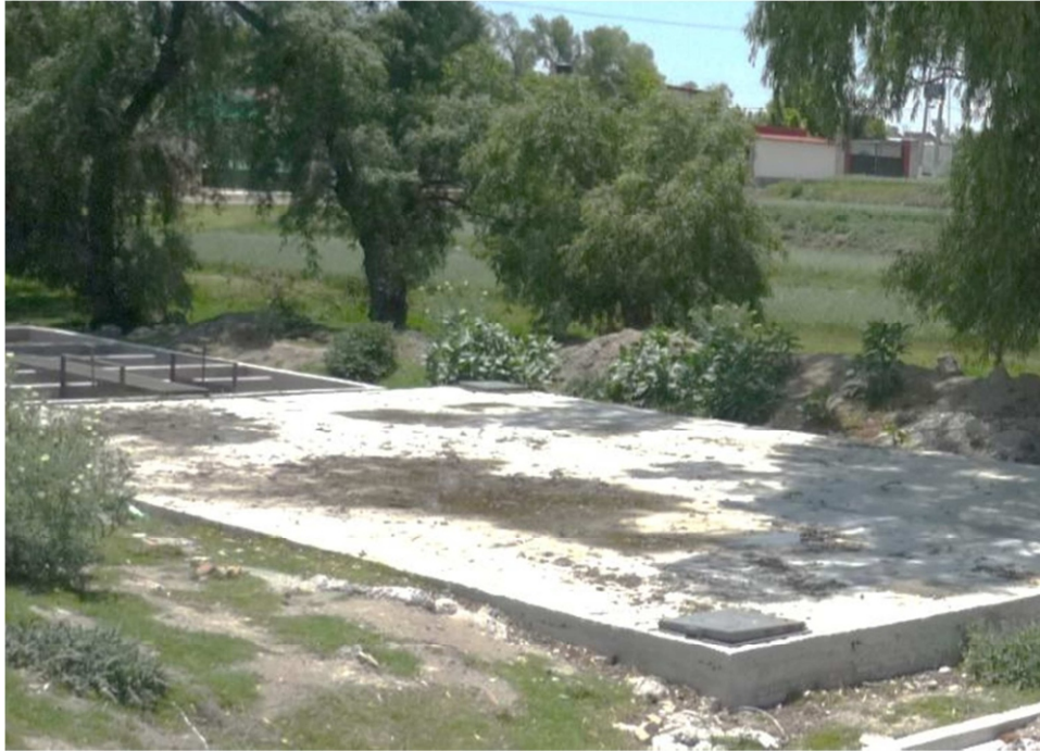
Figura 22. Vista superficial de la estructura de tratamiento primario
