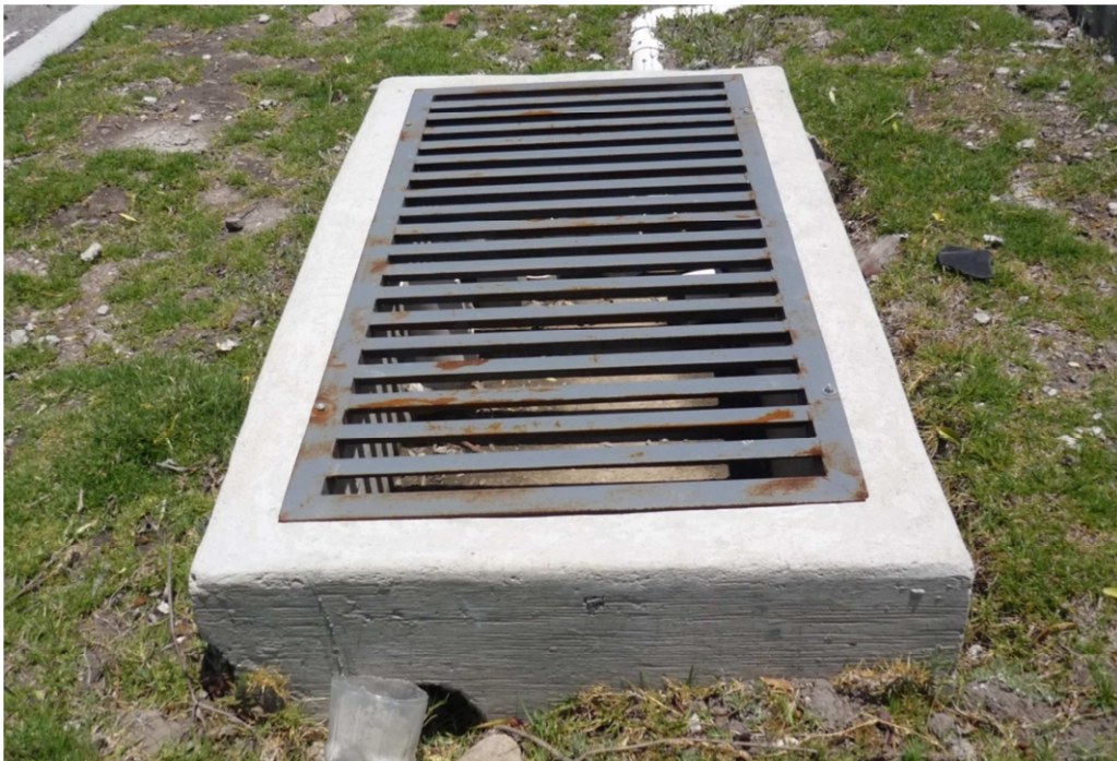
Figura 26. Dispositivo de distribución del agua a los humedales
