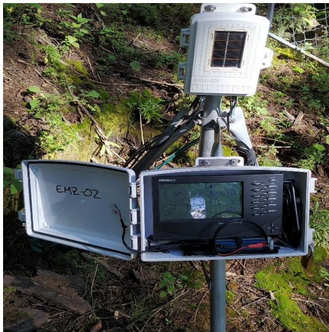
Figura 2 Estación meteorológica automática
