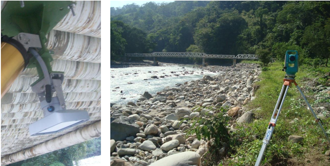
Figura 4-13. Instalación del sensor RLS en el puente El Refugio de la cuenca del Río Teapa
