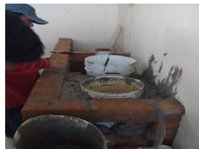
Figura 18 - Se rellenan los espacios con una mezcla de cemento, cal y vidrio
