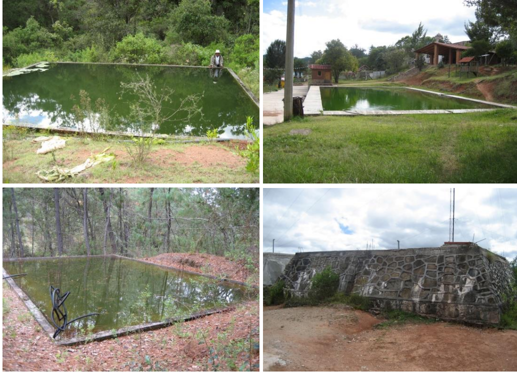
Figura 47. Depósitos de almacenamiento de agua.
