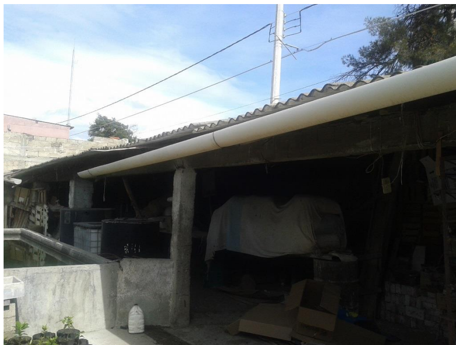
Figura 18. Captación de agua de lluvia.
