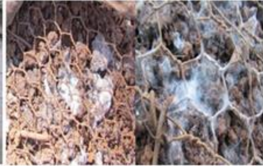
Figura 16. Crecimiento de hongos
