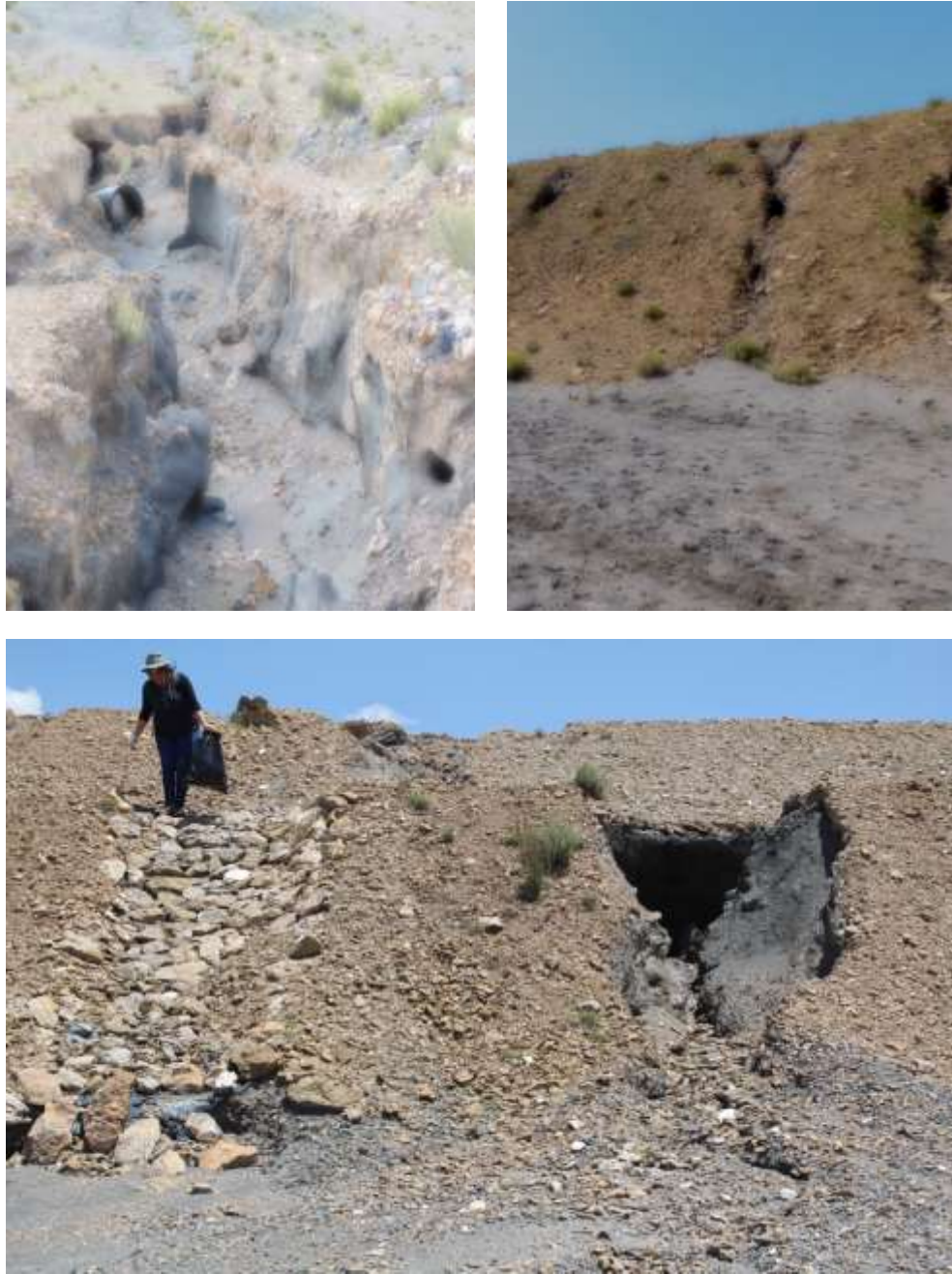
Figura 13. Cárcavas, afloramiento y arrastre de material mal protegido en el pasivo ambiental nuevo.
