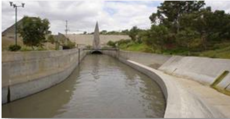
Figura 5 Canales revestidos para la conducción del agua residual
