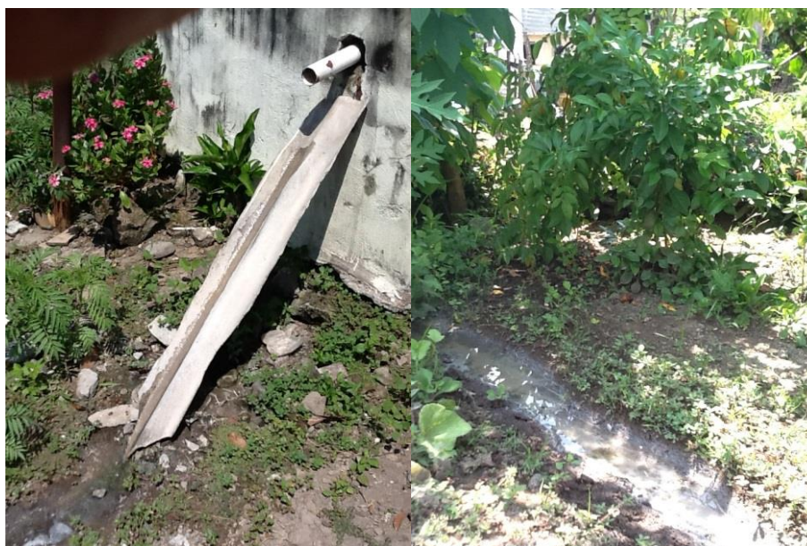
Figura 6 (a y b). Canalización de aguas grises.
