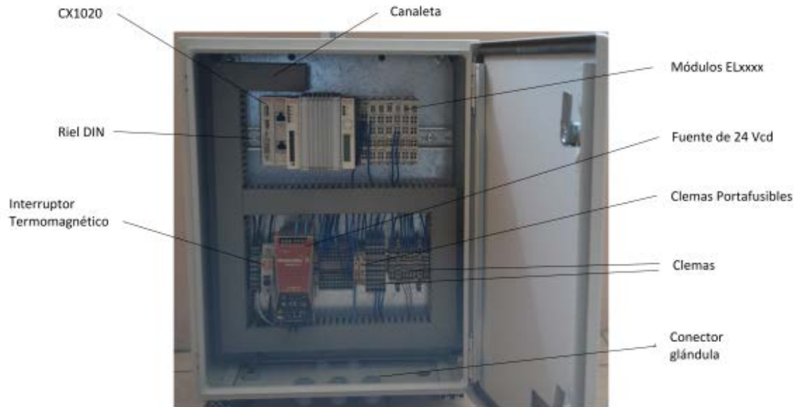
Figura 3.16. Vista general de componentes en gabinete.
