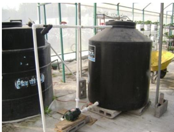
Figura 3. Depósito del sistema de riego.
