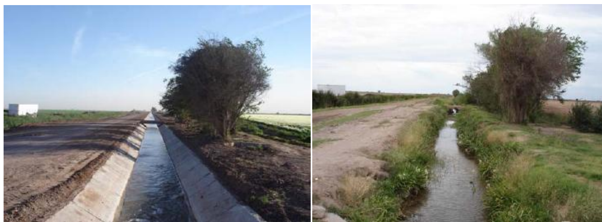
Figura 4.7 Canales en mal estado y de reciente modernización en al año 2006.
