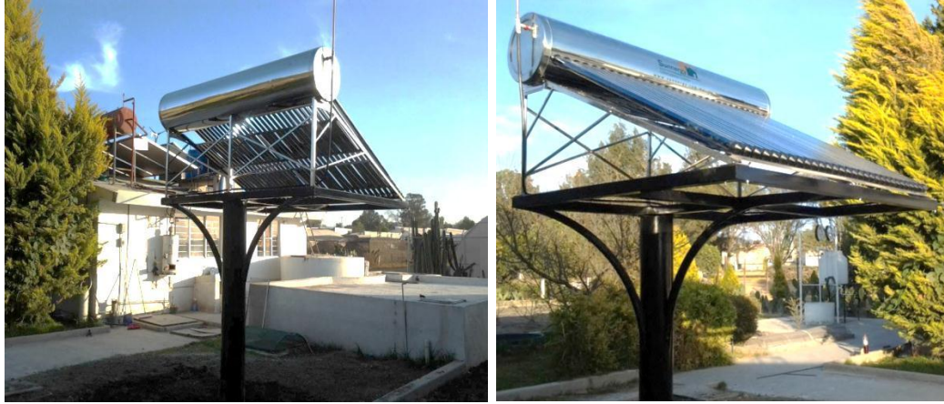
Figura 5.3. Calentador solar instalado en el Campus Montecillo.
