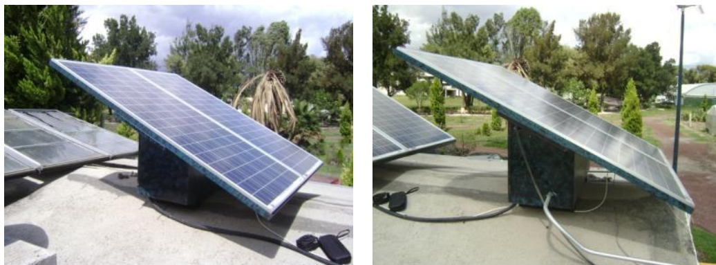
Figura 5.1. Sistema fotovoltaico instalado en el Campus Montecillo.
