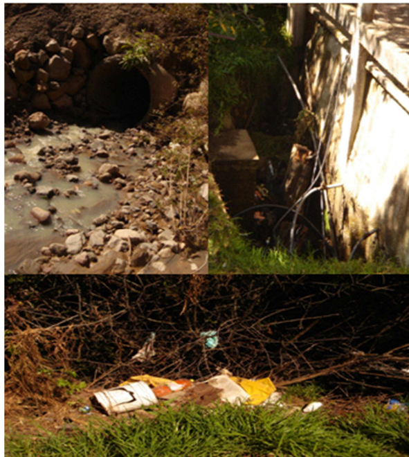
Figura 6.49 Evidencias de la degradación por contaminación antropogénica de residuos sólidos. Parte I
