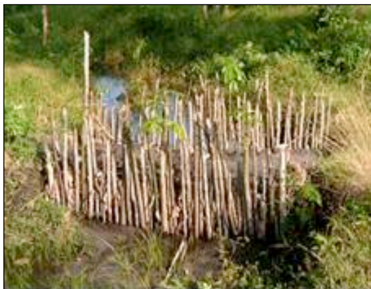
Figura 8. Presas Filtrantes, realizado con material de la región en parcelas del Distrito de Temporal Tecnificado 002 Zanapa-Tonalá
