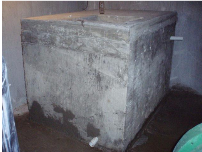
Figura 5.17 Cárcamo para el almacenamiento de agua tratada que cumple con la NOM ECOL-03
