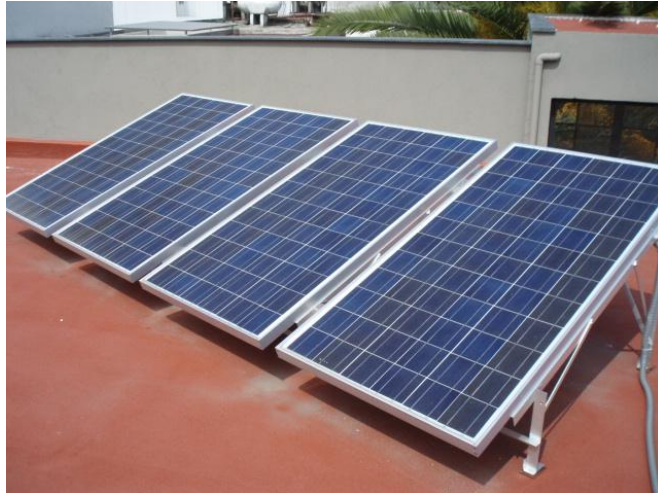
Figura 2.24 Arreglo fotovoltaico interconectado a la red eléctrica pública, Condesa, México D.F (2009).
