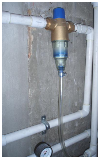
Figura 5.20 vista de filtro Avanty de operación manual.
