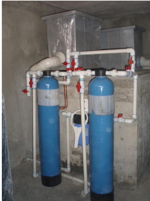
Figura 5.21 Vista de filtro multimedia y carbón activado con válvula manual para retrolavado.
