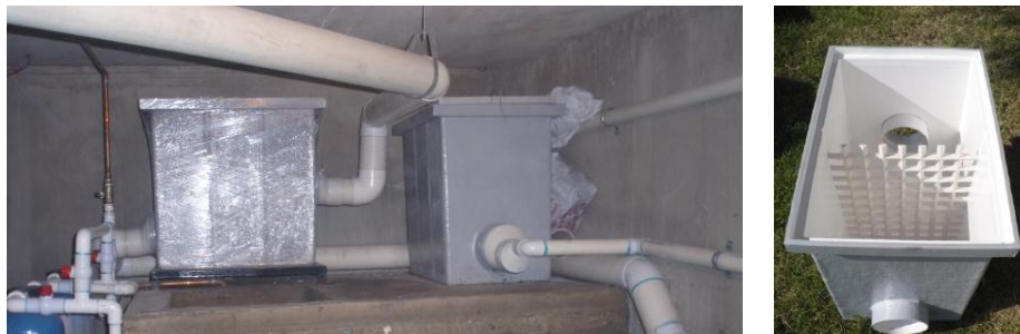
Figura 5.13 Registro para aguas residuales orgánicas y de cocina; y vista de la rejilla (derecha).
