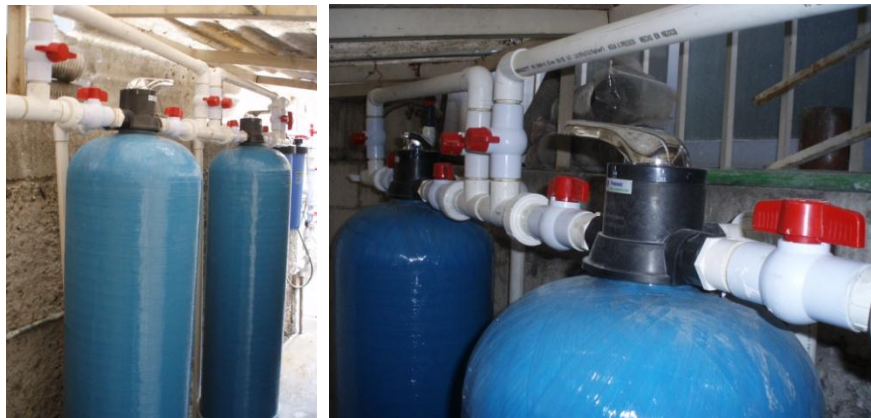
Figura 5.31 Filtro multimedia y carbón activado de 35-52 litros por minuto.
