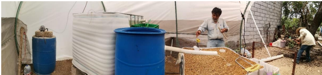
Figura 34 Proceso de construcción del sistema de la familia Díaz Marín. Fuente: Propia.
