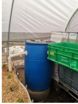
b. Sedimentador de sólidos y biofiltros
