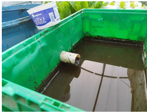
Figura 54 Acumulación de sólidos en el tanque sedimentador. Fuente: Propia.
