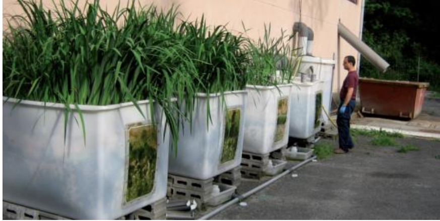
Figura 5. Módulos piloto de humedales de flujo vertical para el tratamiento de aguas residuales en España
