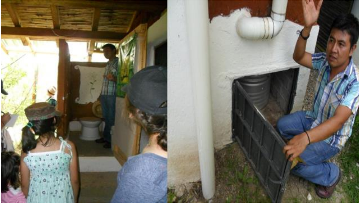
Figura 75. Baños ecológicos con sistema de digester anaeróbico y letrinas secas.
