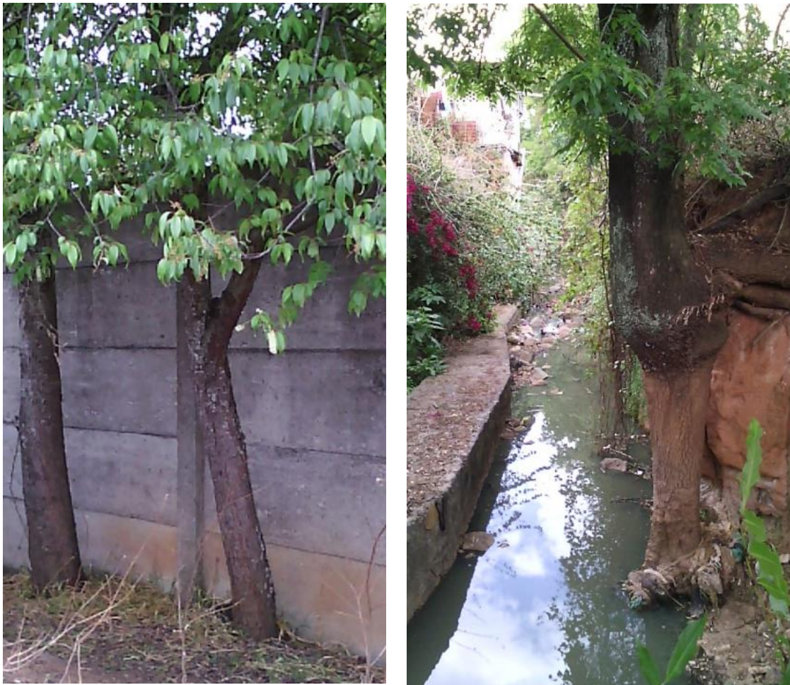
Figura 46. Arbolado en situación de riesgo dentro del predio.
