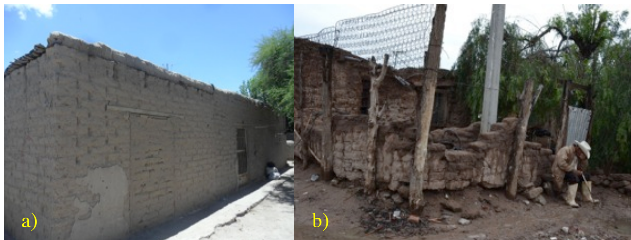
Figura 31. a) vivienda de adobe sin revestimientos y con techos en mal estado, b) casa de adobe con daño estructural a punto de caerse por la humedad.
