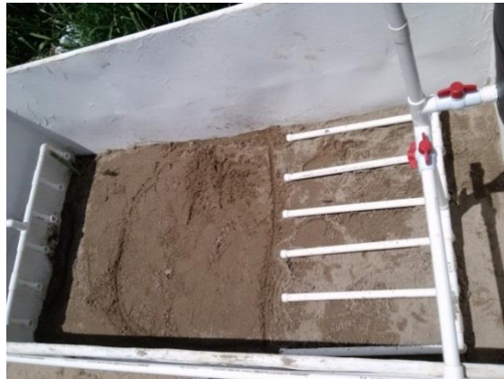
Figura 9. Instalación interna de tuberías y material de soporte dentro del reactor de flujo libre para el tratamiento de aguas residuales en la División Académica de Ciencias Biológicas
