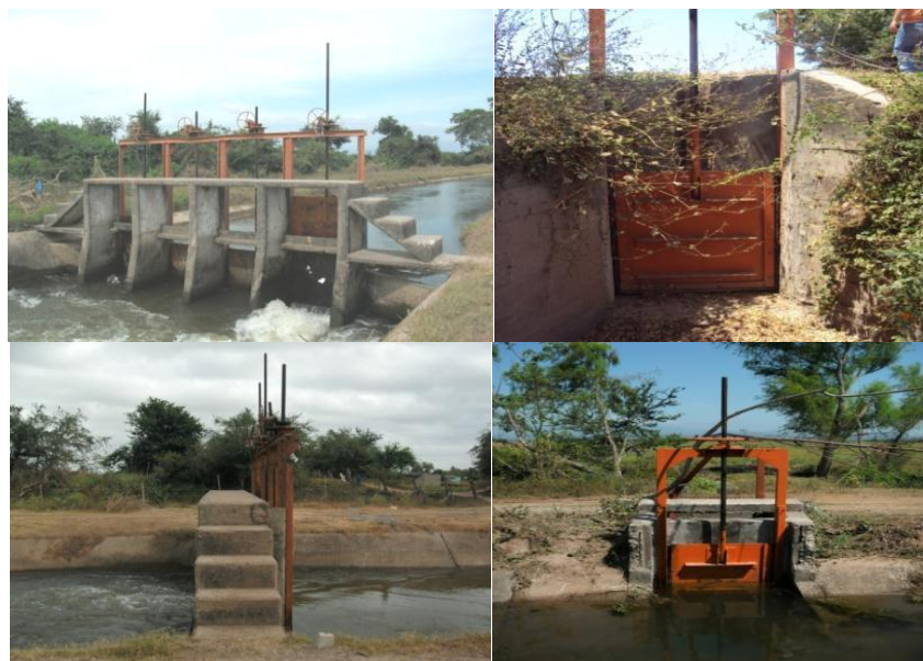
Figura 4.6. Estructuras de operación en el distrito de riego 043 Estado de Nayarit. Fuente: Informe de actividades, SIG distrito de riego 043, CONAGUA, 2010.
