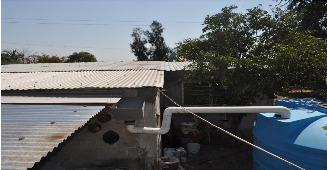
Figura 5. Sistema de captación de agua de lluvia de evaluación.
