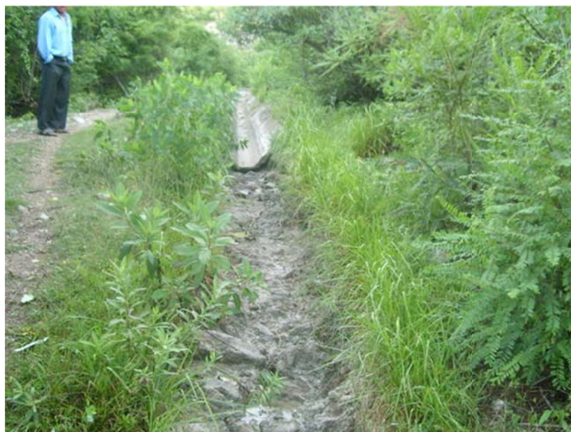
Figura 5. Canal con revestimiento inconcluso
