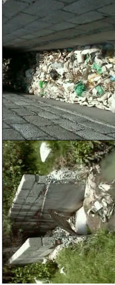
Figura 5.4 Entrada de un sifón donde se acumulan residuos sólidos
