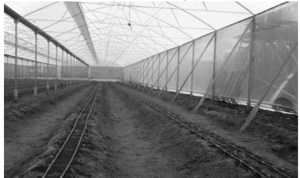
Foto 11. Sistema de riego por goteo
