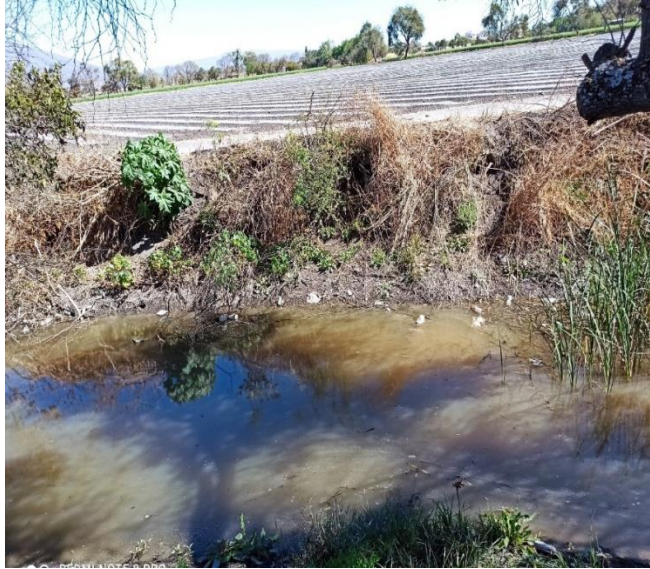
Figura 8. Canal de agua con presencia de basura y poco mantenimiento.
