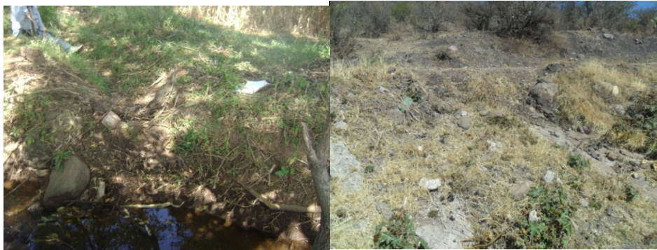
Figura 25. Estructuras de Protección en los Distritos de riego de la Cuenca Lerma-Chapala
