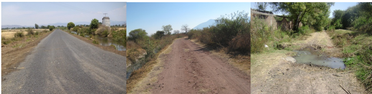
Figura 27. Red de caminos en los Distritos de Riego de la Cuenca Lerma-Chapala
