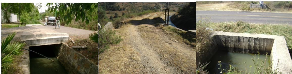
Figura 24. Estructuras de cruce en los Distritos de riego de la Cuenca Lerma-Chapala
