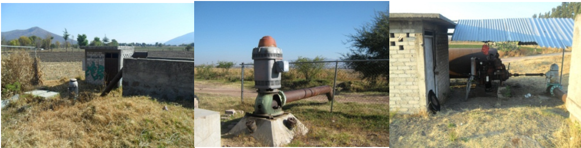
Figura 28. Pozos en los Distritos de Riego de la Cuenca Lerma-Chapala
