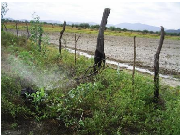
39- Pozo 2 Las Palomas (fuga)
