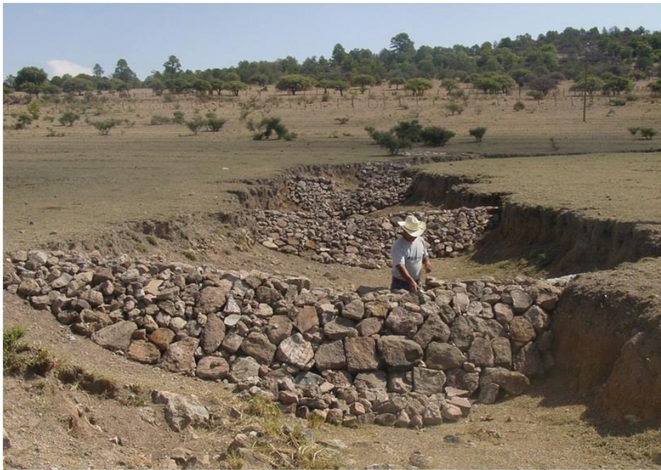
Figura 26. Presas de piedra acomodada para el control de la erosión en cárcavas
