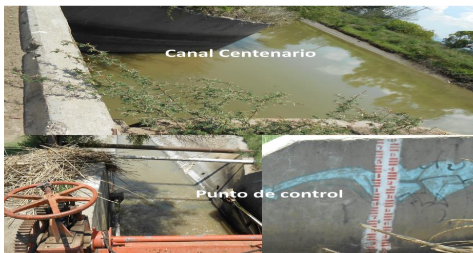
Figura 19 Canal Centenario y punto de control donde se recibe el agua en el Módulo Valle
