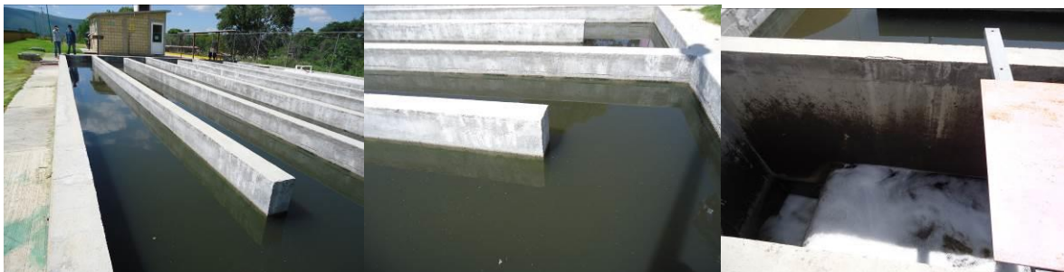
Figura 16. Tanque de contacto con cloro
