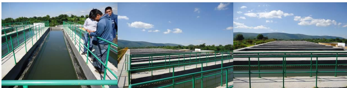
Figura 12. Módulos del reactor UASB
