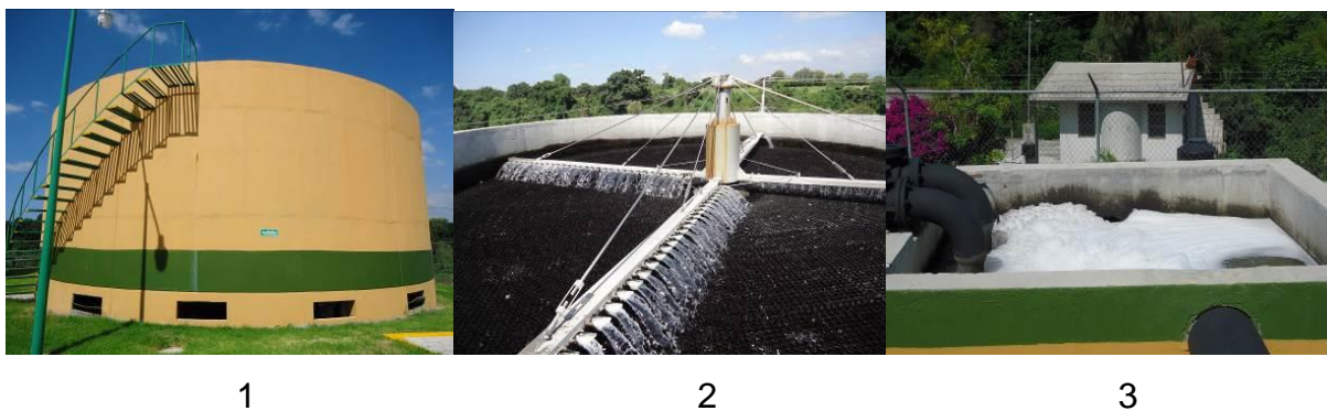
Figura 14. Tratamiento secundario. Filtro percolador (1), Panel plástico (2), Tanque de recirculación (3)
