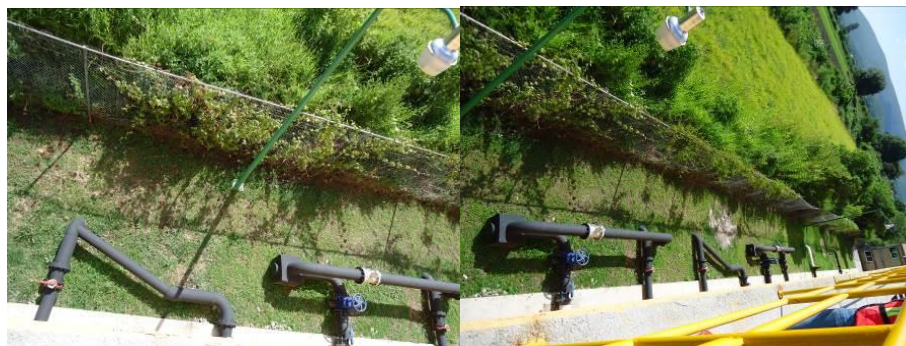
Figura 13. Válvulas de control de reactor UASB
