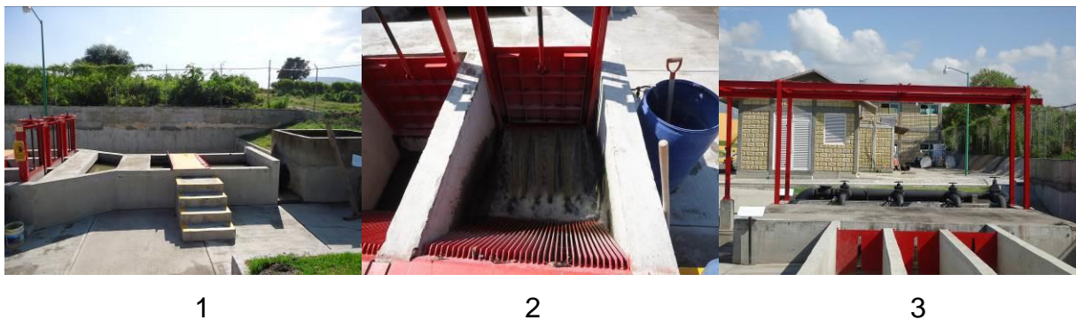
Figura 9. Tratamiento primario. Caja de disipación (1), Rejillas (2), Desarenadores (3)
