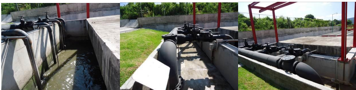
Figura 11. Cárcamo de bombeo
