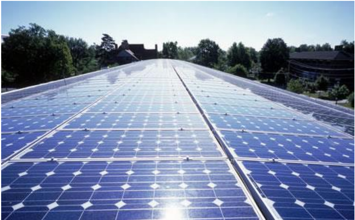
Figura 4. Paneles solares para generar energía eléctrica urbana
