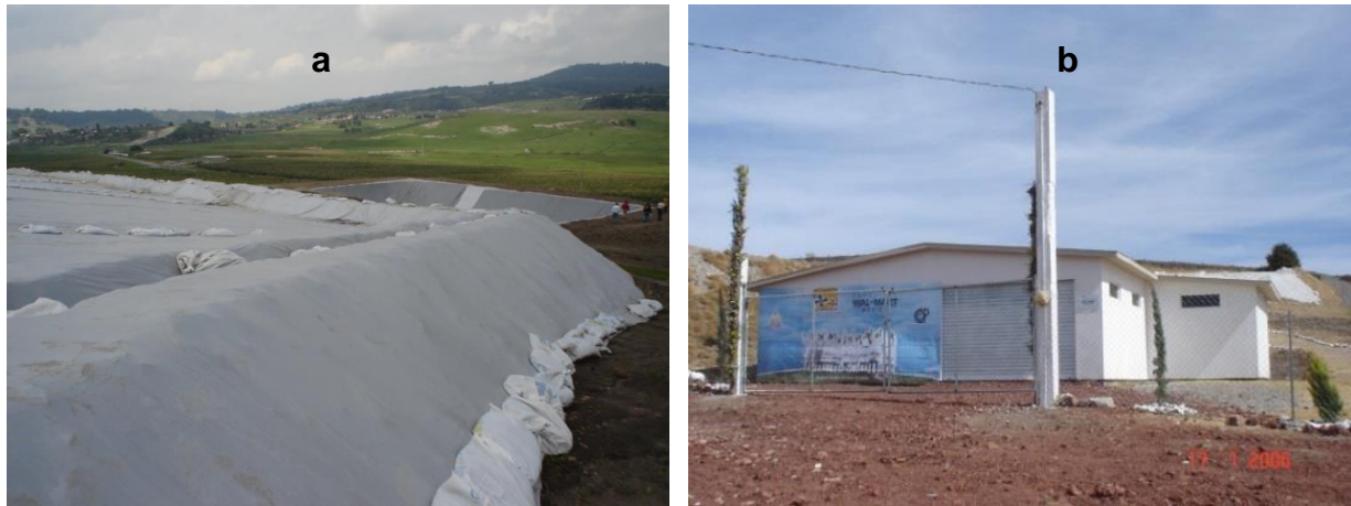
Figura 6. SCALL con el grupo étnico Mazahua, a) Colocación de geomembrana de PVC en 4,000 m 2 de área de captación y b) Caseta de planta purificadora Maz-Agua.
