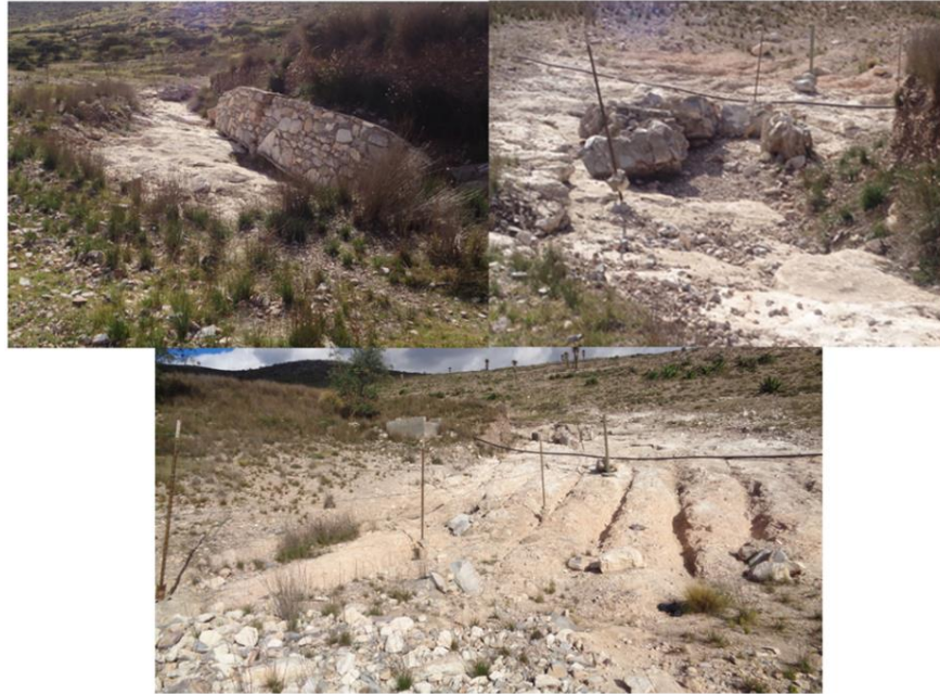
Figura 1.13. Daños en vertedor y desagüe del bordo La Cueva, Cinco de Febrero, Venado, S. L. P.
