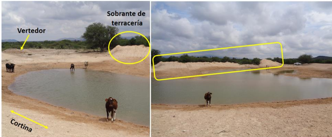
Figura 1.14. Excedente de arcilla para construcción de la cortina del bordo El Botón en Agua de en Medio, Venado, S. L. P.
