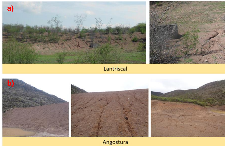
Figura 1.11. Agrietamiento en bordos de almacenamiento. Rioverde (a) y San Luis Potosí (b).
