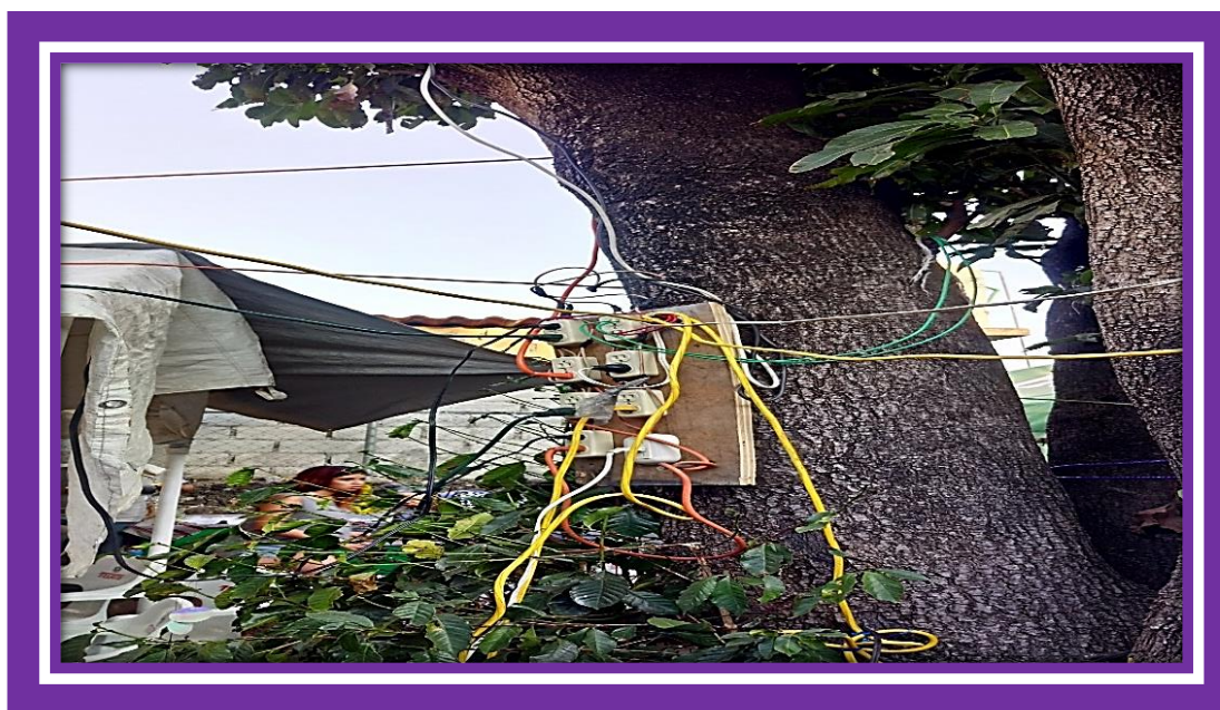
Fotografía 7. Conexiones eléctricas del Chelodromo
