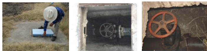
Válvula principal de la Bomba del pozo de San Luis
