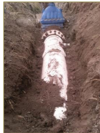
Figura 13. Tubería y válvula.
