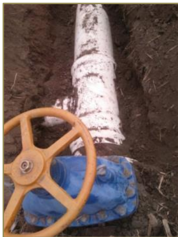
Figura 12. Tubería y válvula.
