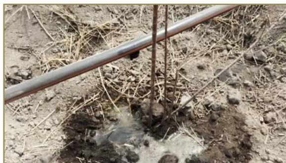
Figura 33. Gotero en funcionamiento.
