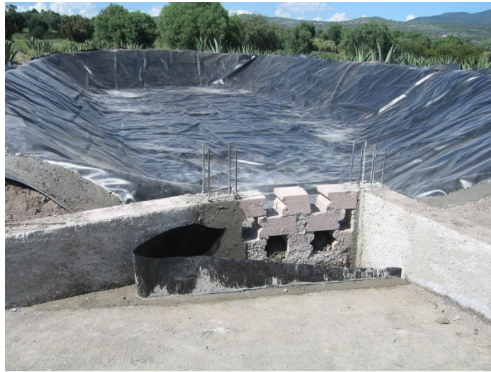
Figura 8. Olla de captación cubierta con la geomembrana, al frente la trampa de sedimentos.
