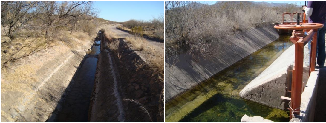
Figura 6. Red de conducción en Módulo 1
