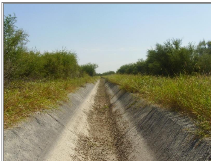
Figura 9. Red menor de canales en el Distrito de Riego 004, Don Martín.
