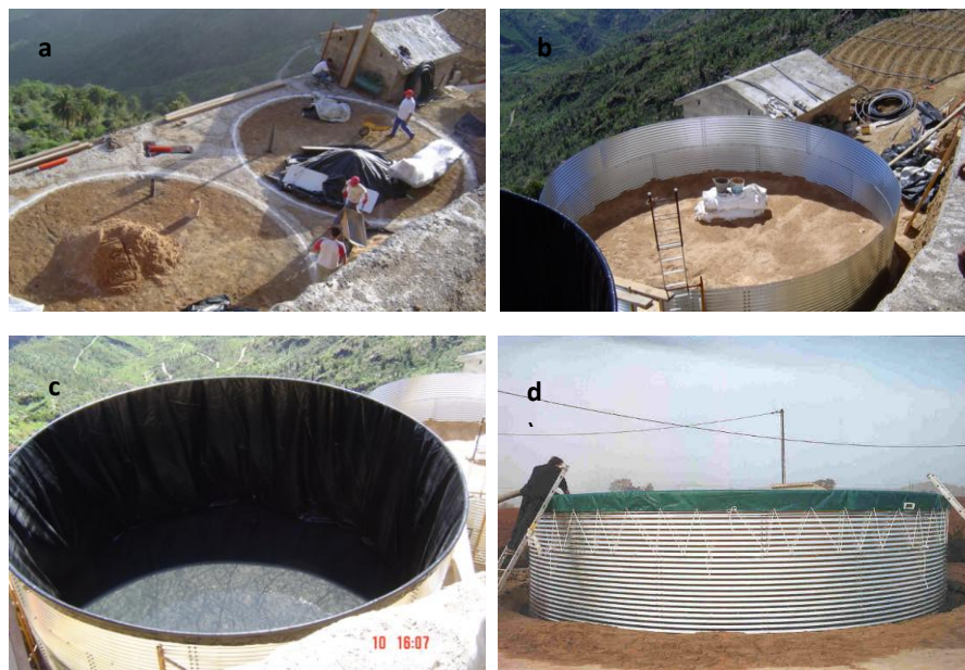
Figura 13. Instalación de un depósito metálico. a) Preparación de la base de hormigón; (b) Montaje de las paredes del depósito; c) Colación de la bolsa de geotextil; d) Montaje final con la lona de PVC. Fuente: grupo Sabater.
