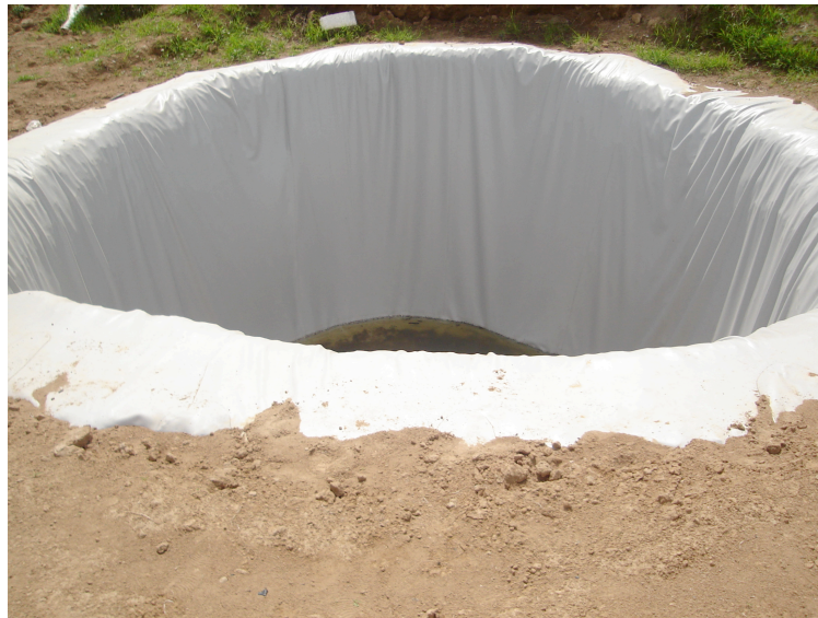
Figura 19. Cisternas revestidas con geomembrana. Ixtacuixtla, Tlaxcala.
