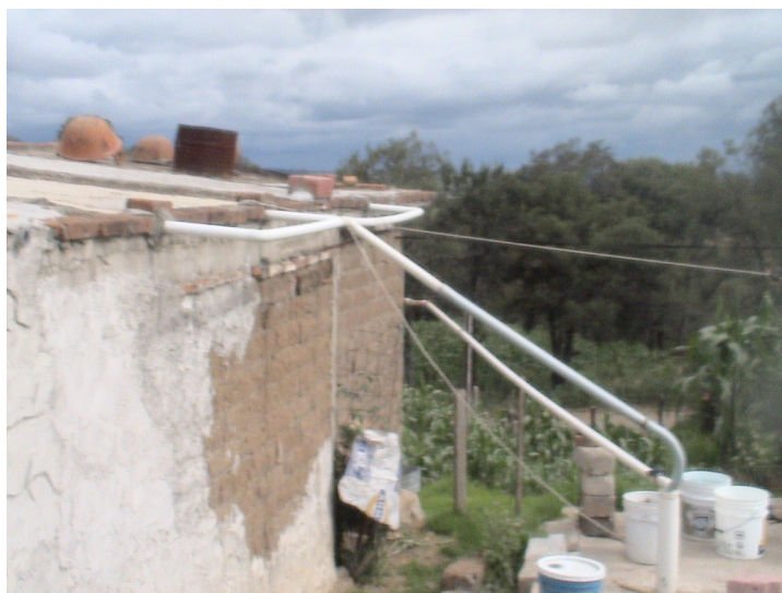
Figura 16. Tubería de PVC para la conducción del agua de lluvia, Españita Tlaxcala.
