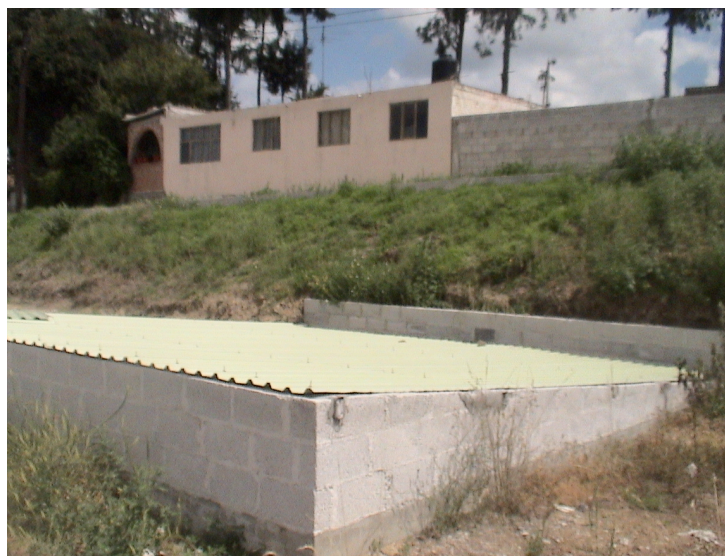
Figura. 15. Techos de lámina de acero inoxidable para la captación del agua de lluvia. Ixtacuixtla, Tlaxcala.
