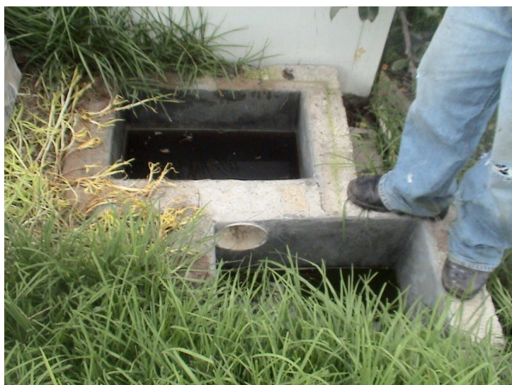
Figura 17. Sistema de filtración de impurezas del agua de lluvia captada.
