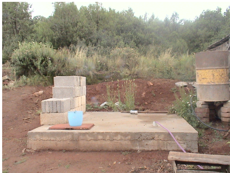
Figura 20. Cisterna de block. Toluca de Guadalupe, Terrenate, Tlaxcala.
