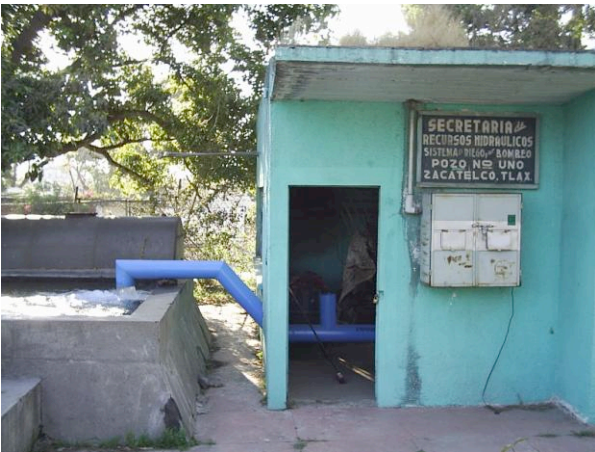
47. Pozo 1 Zacatelco (No. 24. IM; No.47. IIM) (No. 24 IM; No. 47 IIM)
